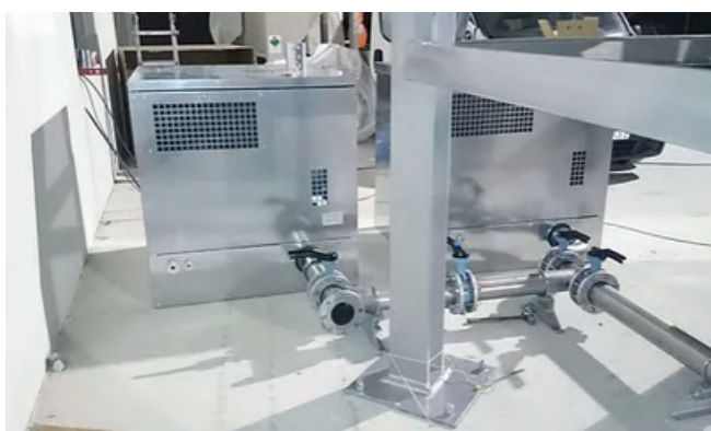
Ejemplo de 2 compresores con válvulas by-pass
