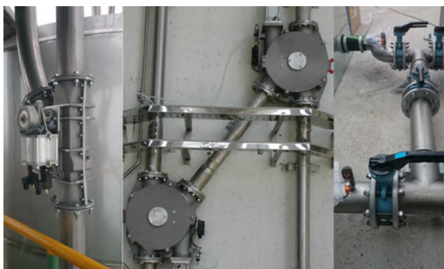
Sistema de desviadores y válvulas para entrelazar líneas de transporte neumático
