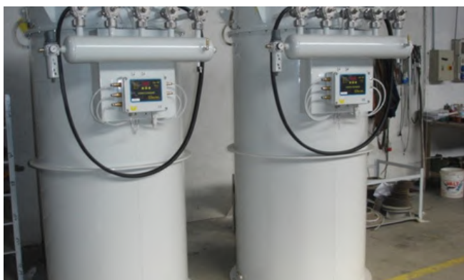
Filtros de mangas
