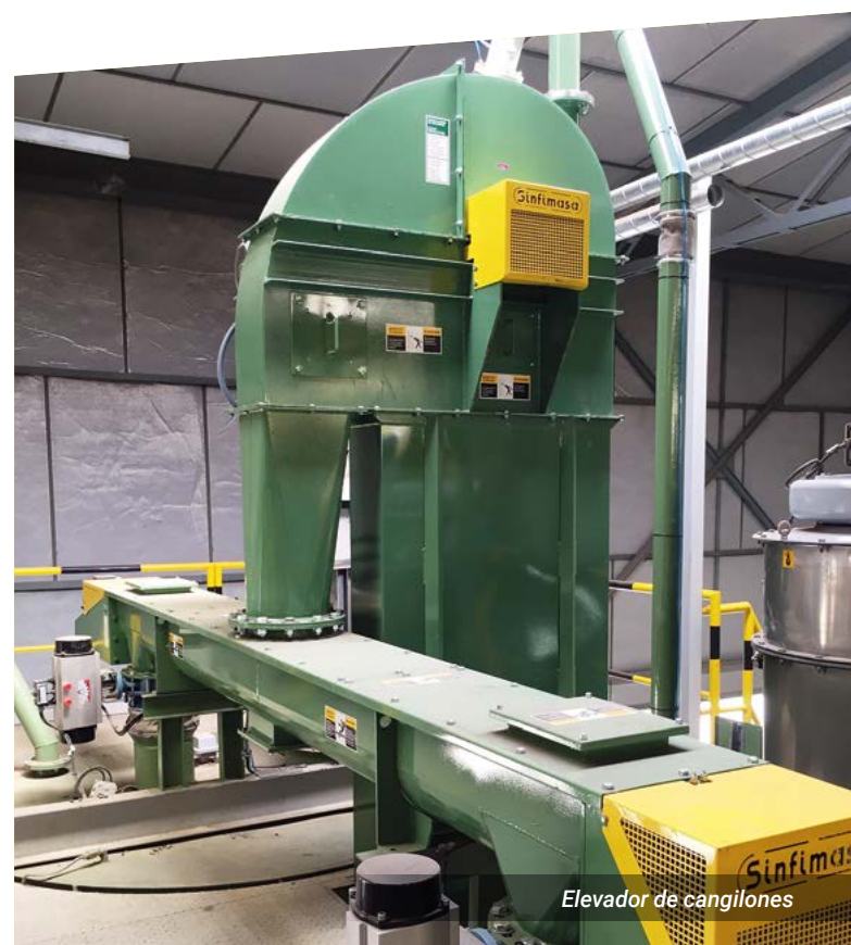
Elevador de cangilones
